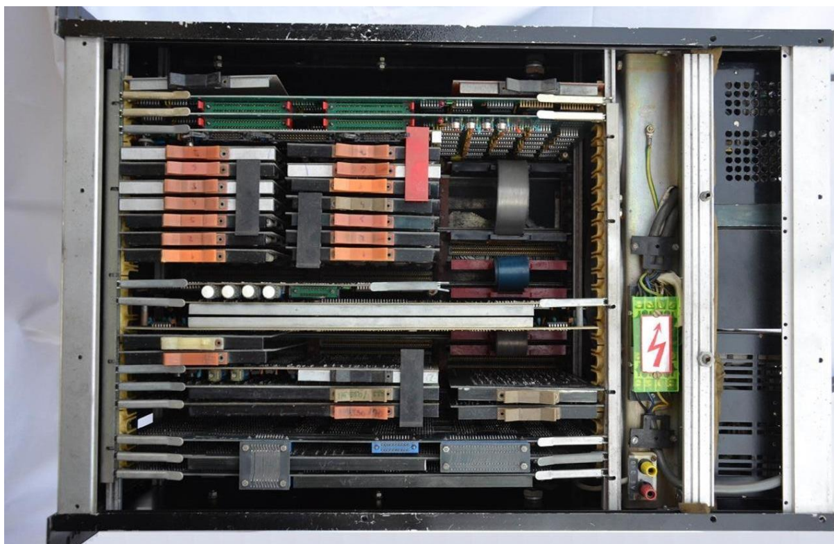
Obr. 4: Pohľad do vnútra procesorového roštu počítača SMEP SM 4-20, ktorý je osadený doskami procesora CM 2401, polovodičovej operačnej pamäti CM 3511, riadiacej jednotky (RJ) kazetových diskových pamäti a RJ magn. páskových pamäti.
